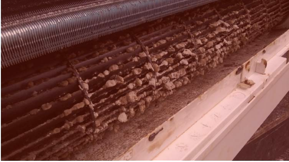
Bakımı yapılmamış bir klimanın görüntüsü
